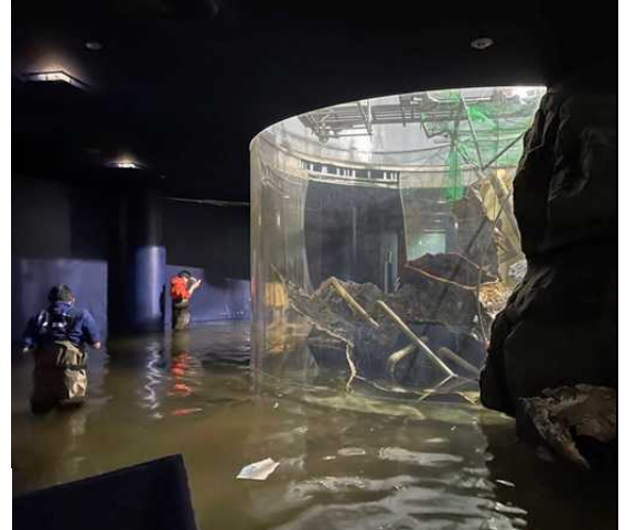
破損直後のビワコオオナマズ水槽
