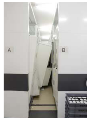
写真4 収蔵庫の被害状況。固定棚（左列）のキャビネットは転倒したが、可動棚（右列）のキャビネットは転倒しなかった。
